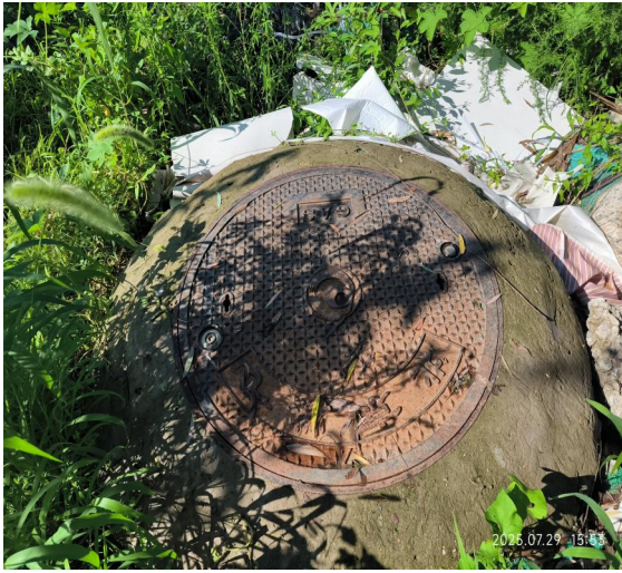
项目内燃气井
