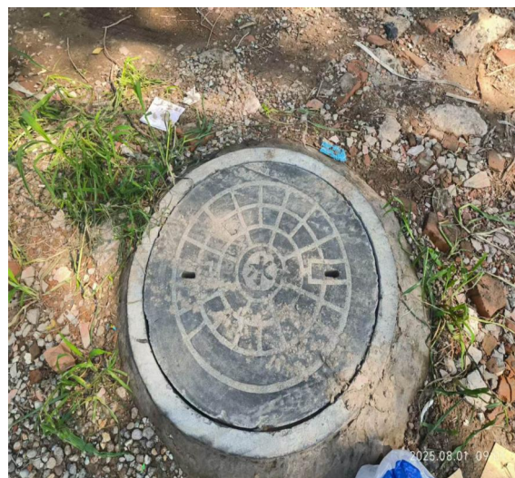
项目内上水井
