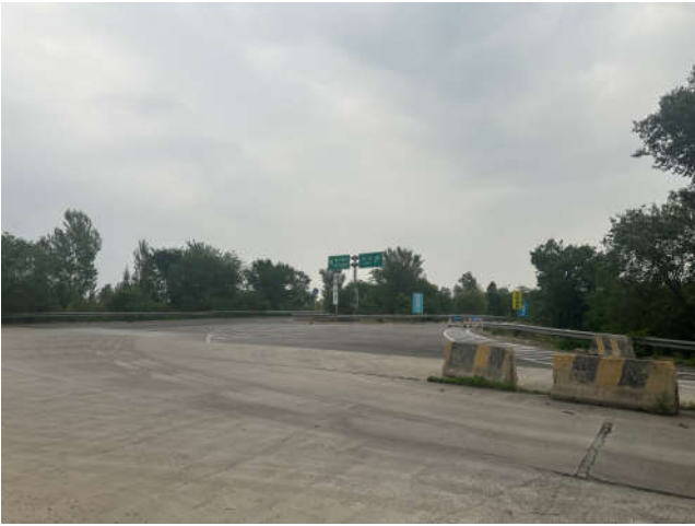
现况车道标线破损
