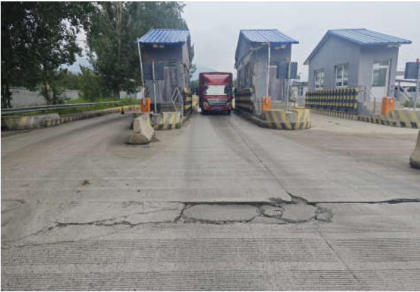
现况混凝土路面破损
