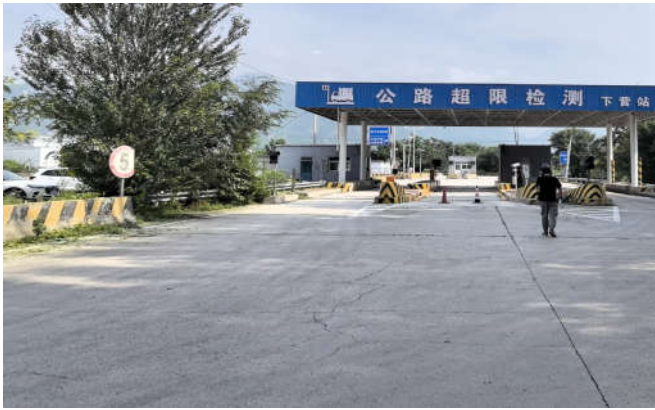
现况混凝土路面破损
