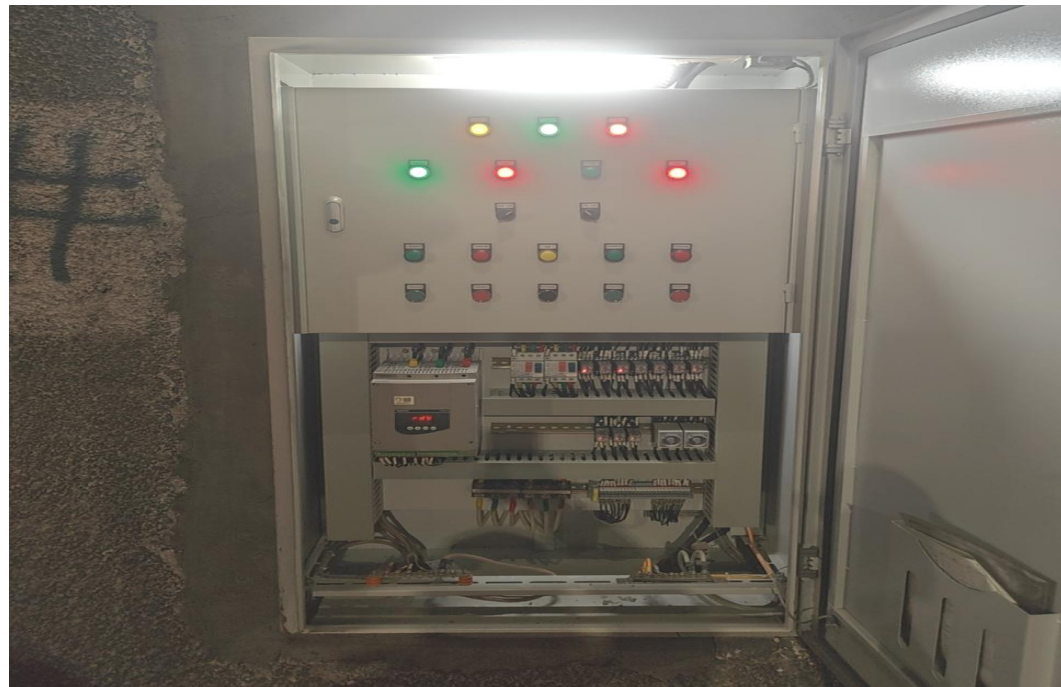
图 2-1-15 风机控制柜现状图
