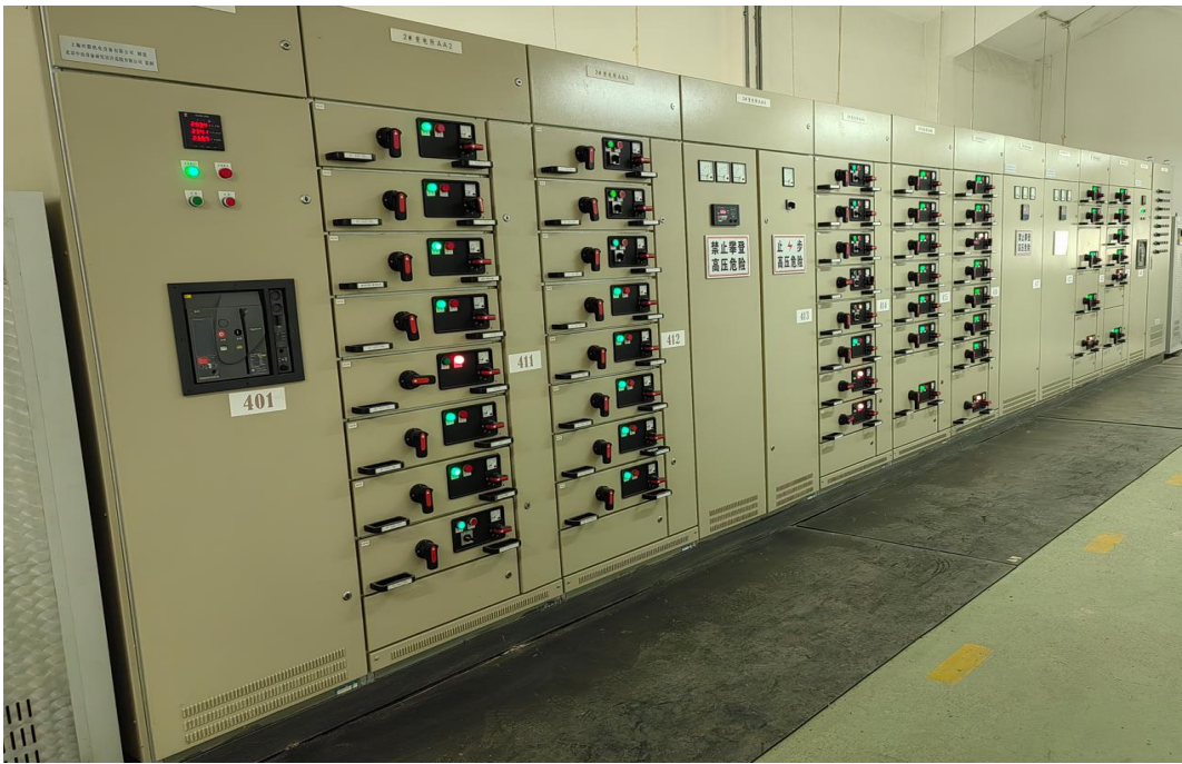
图 2-1-2 配电柜现状图
