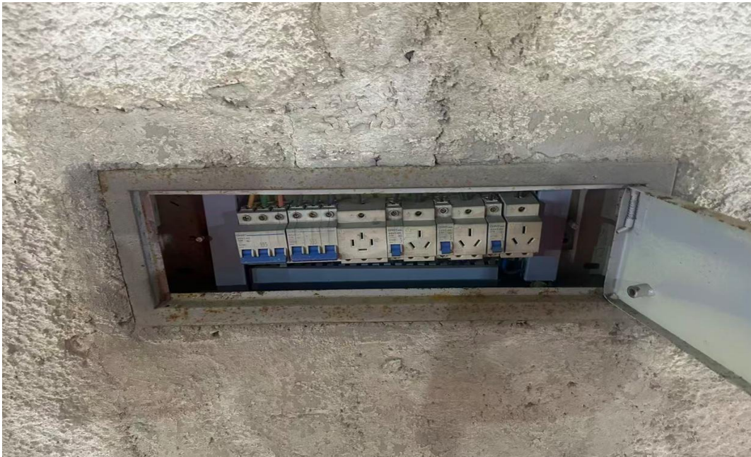
图 2-3-3 检修配电箱现状图
