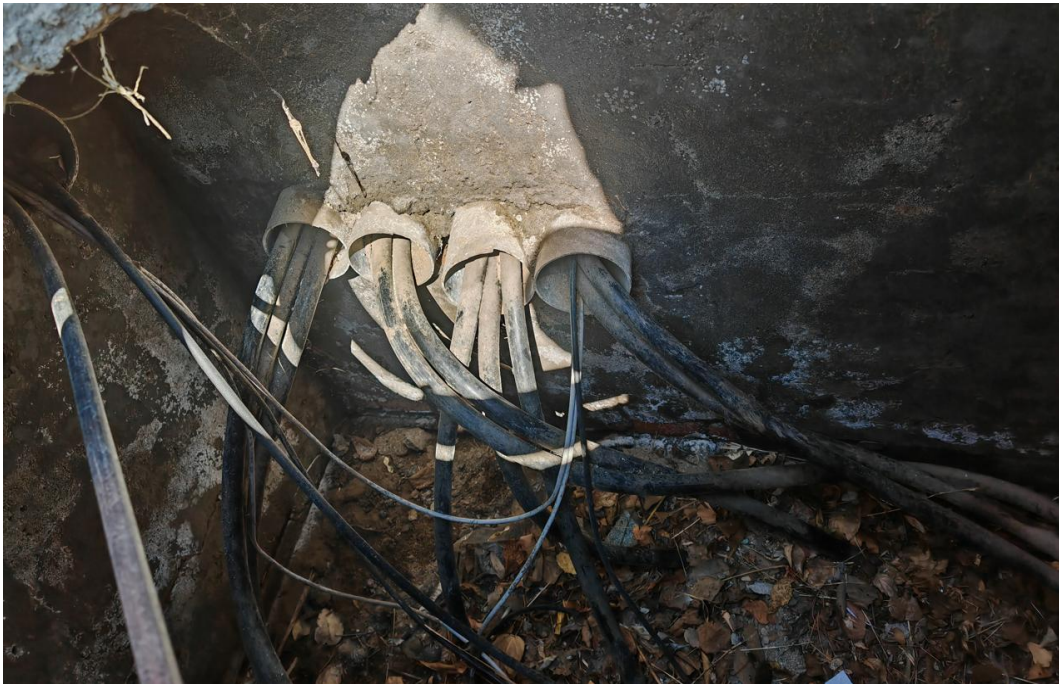
图 2-1-6 电源电缆现状图
