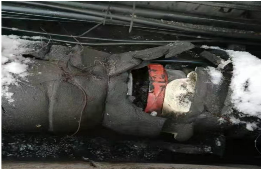
图 2-1-23 隧道内消防管道管箍现状图
