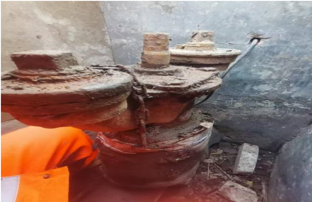
图 2-1-19 消防管道阀门组件现状图
