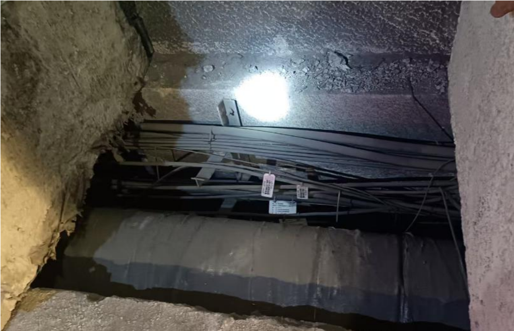
图 2-1-7 电源电缆现状图
