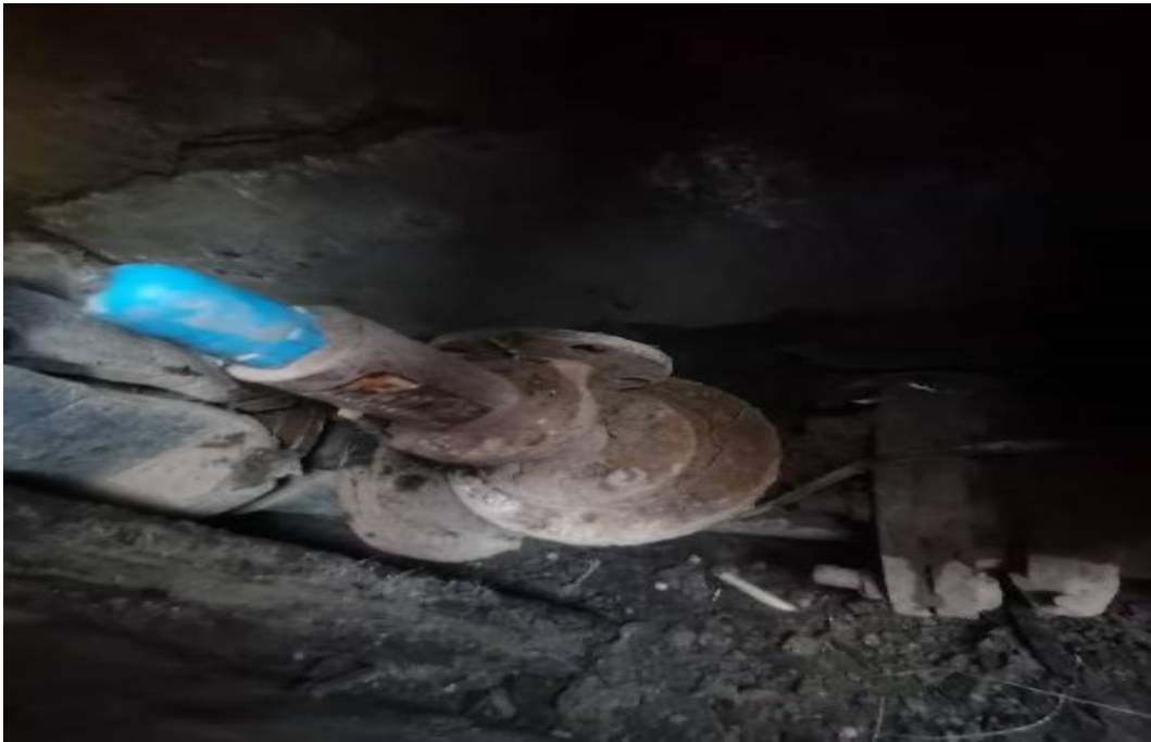
图 2-1-20 消防管道阀门组件现状图
