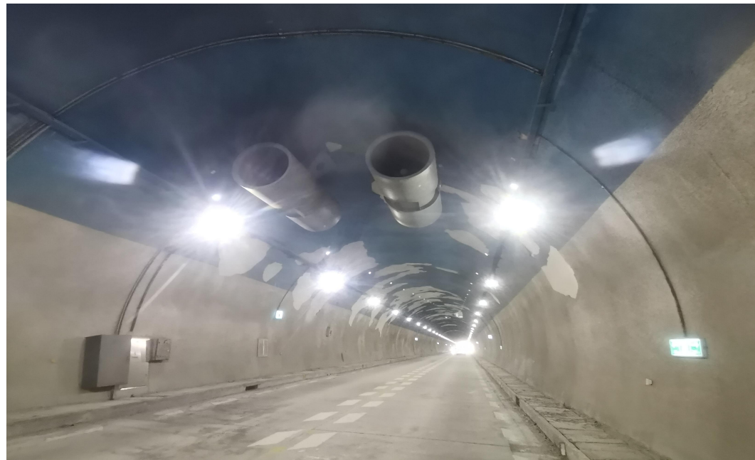
图 2-2—7 瓦庙隧道风机现状图
