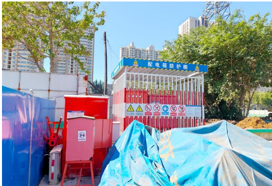
项目内不依比例尺变电箱
