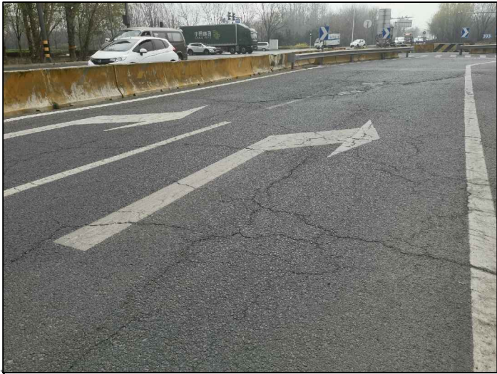
路面龟裂、防撞护栏缺失
