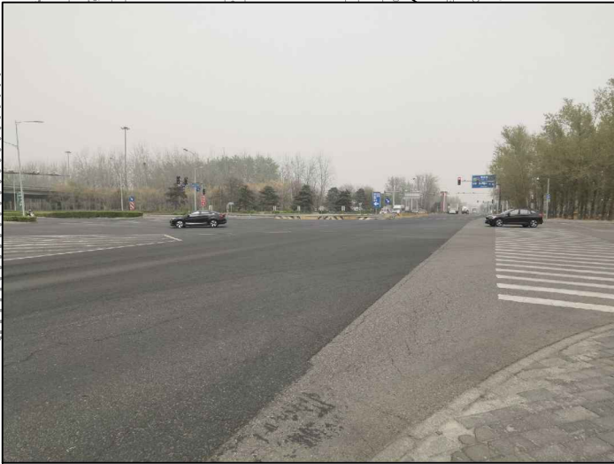
路面龟裂、人行步道砖破损
