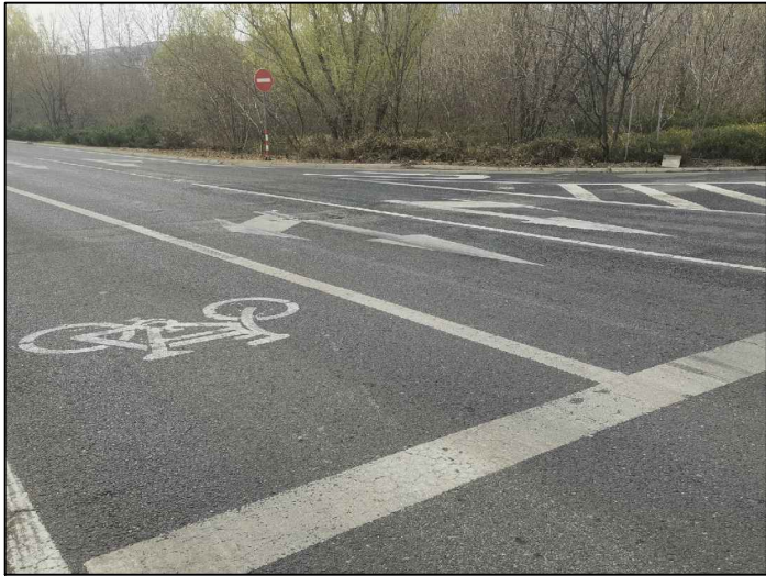
纵向裂缝、标线磨损
