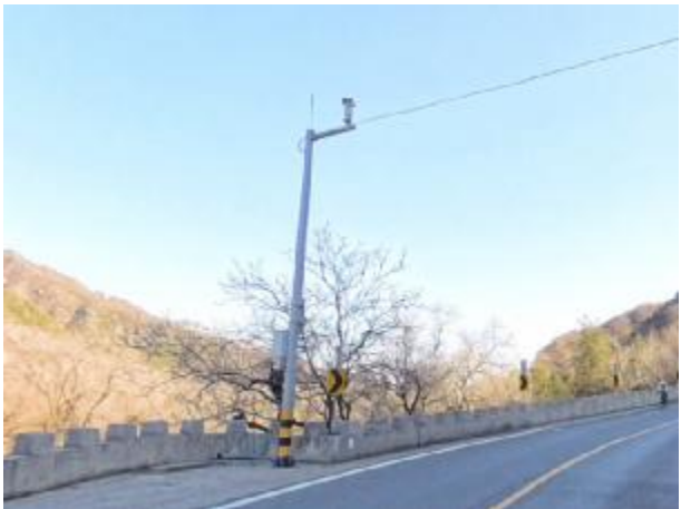
图 2-3 现况视频监控设备
