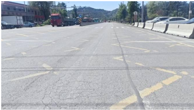
标线磨损严重
