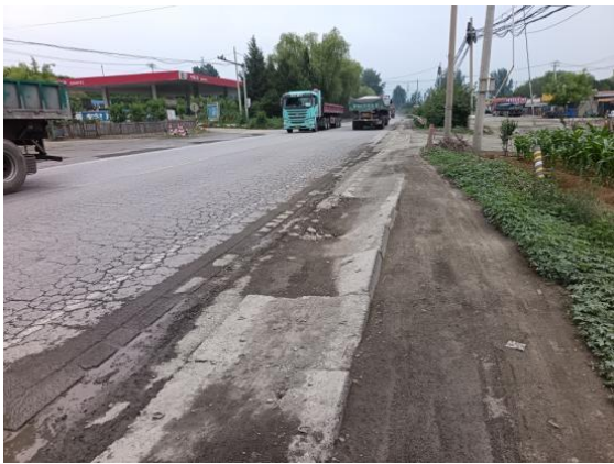
边沟沉陷+盖板露筋
