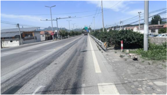
车辙（松树峪综合检查站附近）
