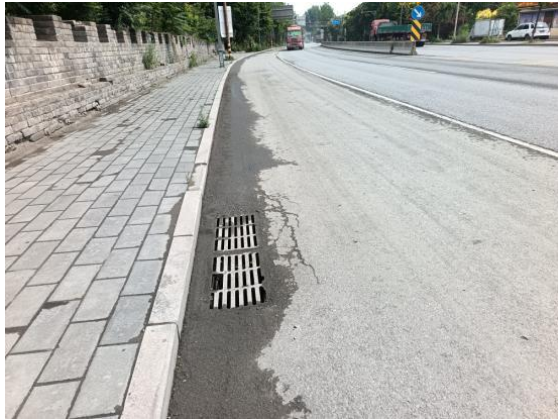
雨水篦子损坏
