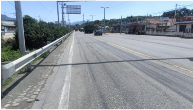
车辙（松树峪综合检查站附近）
