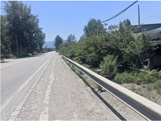
盖板边沟损坏
