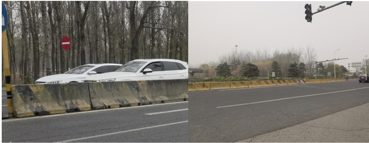
图 2.7.2-1 混凝土防撞墩破损、交通安全设施缺失
