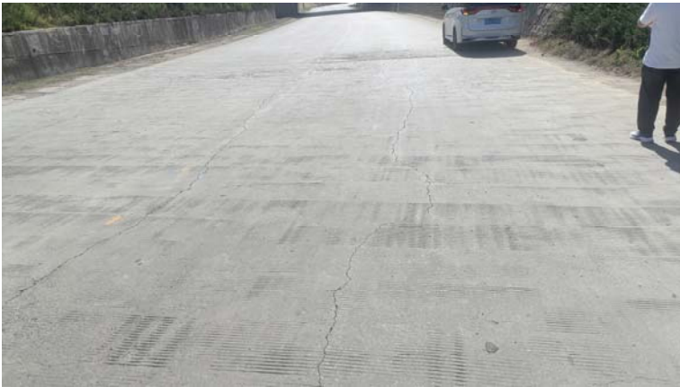
标线磨损严重
