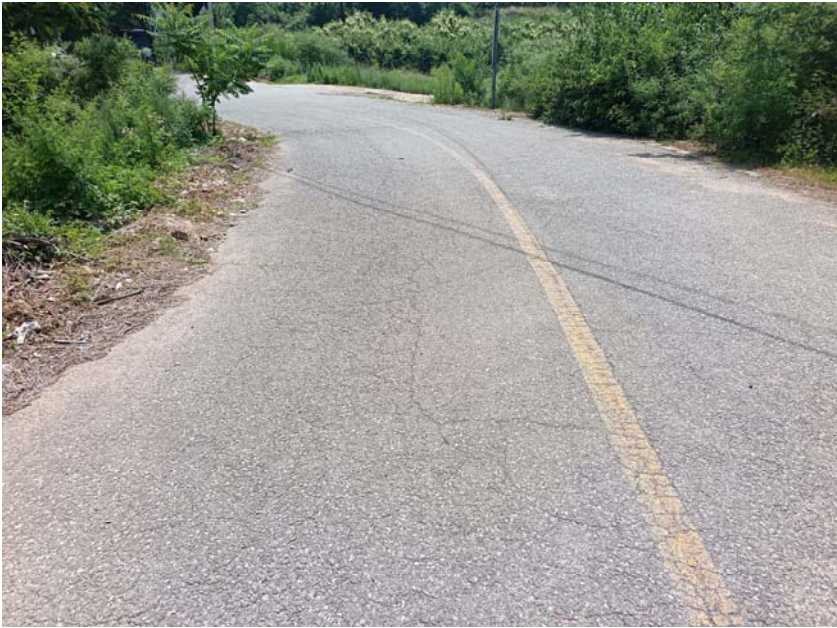
标线磨损严重
