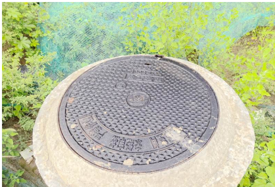
项目内下水检修井
