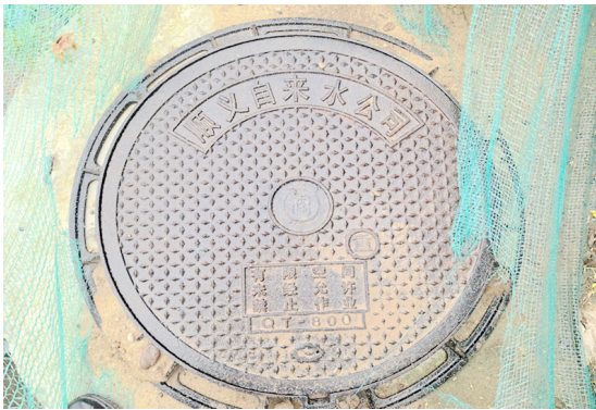
项目内上水检修井
