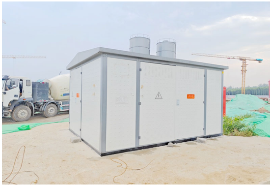
项目内配电箱
