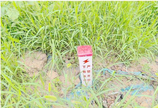
项目内电缆桩
