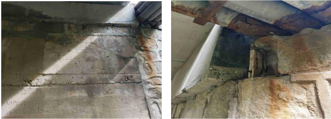
图 2.4.2-6 混凝土裂缝（左）和锈胀开裂（右）
