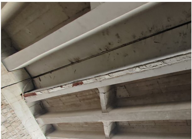
图 2.4.4-4 加固钢板局部轻微锈蚀
