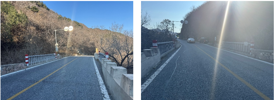
图 2.4.3-1 桥面铺装磨光露骨
