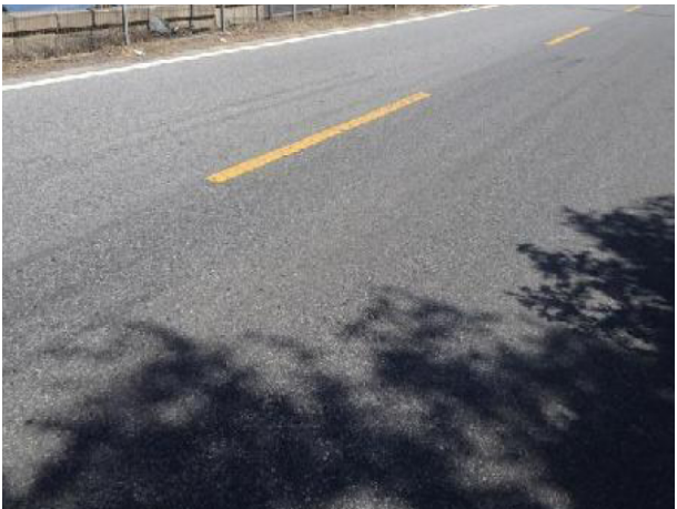
图 2.4.4-2 桥面铺装磨光露骨
