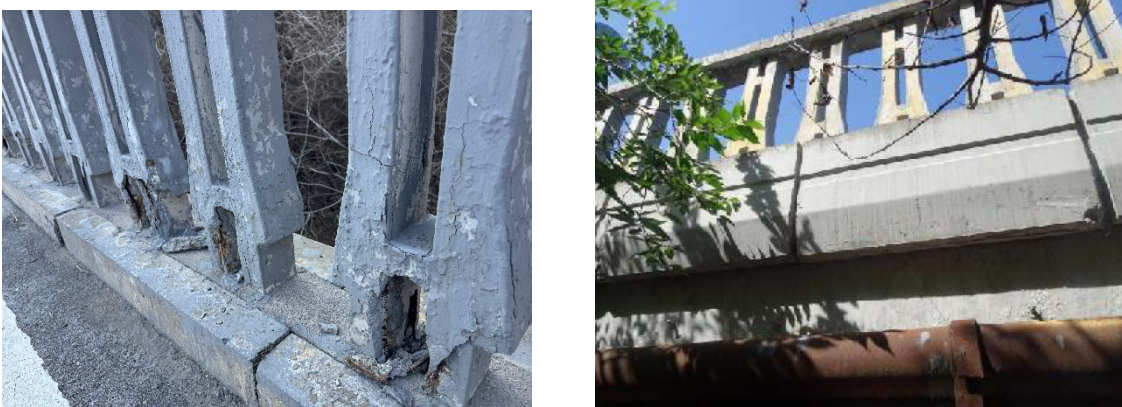
图 2.4.3-2 混凝土护栏和地袱锈胀露筋
