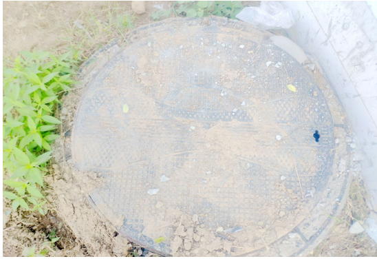
项目内上水检修井
