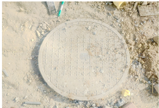
项目内电力检修井
