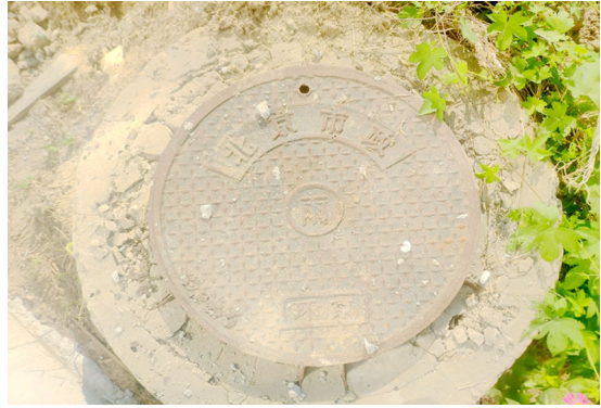
项目内下水检修井
