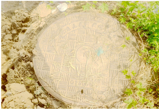
项目内热力检修井
