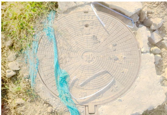
项目内通信检修井
