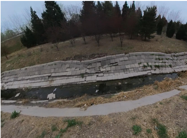
现况边沟坍塌严重
