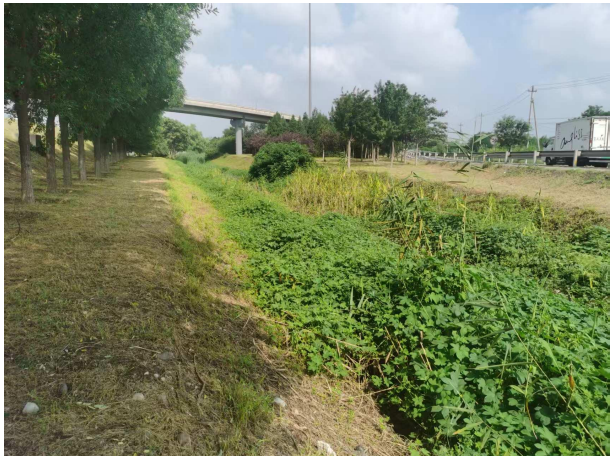
沿线土质边沟淤积严重
