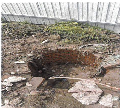
项目内再生水井情况
