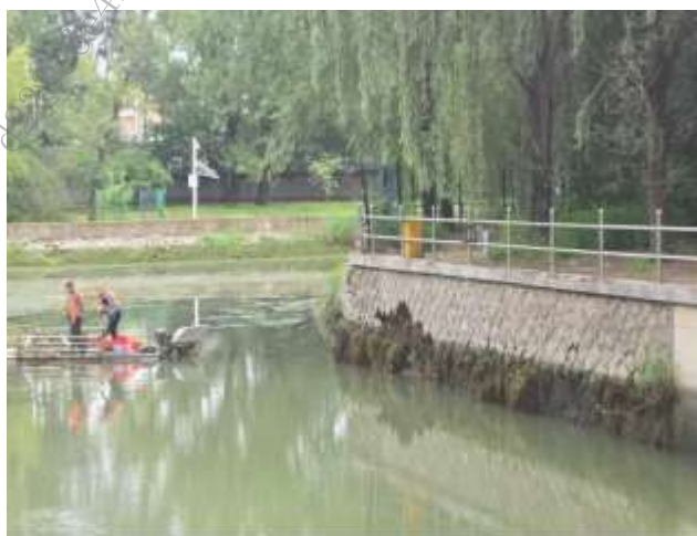
图 5 大柳树朝丰闸下游 100 米右岸护坡坍塌
