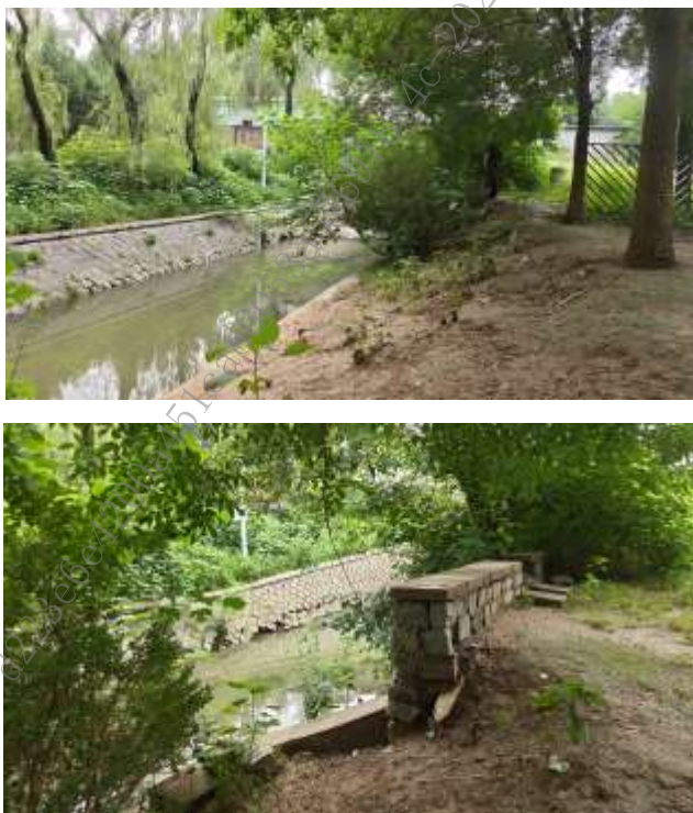
图 2 小场沟闸下游 20 米两岸护坡坍塌
