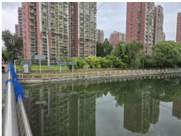
图 3 大柳树沟天达路桥下游河道北侧护坡坍塌
