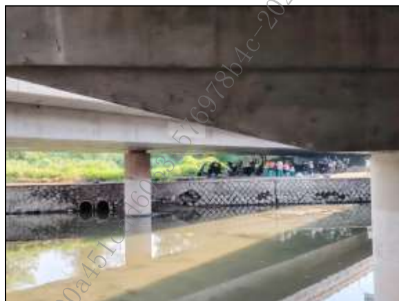
图 7 萧太后河五环桥下两岸挡墙坍塌
