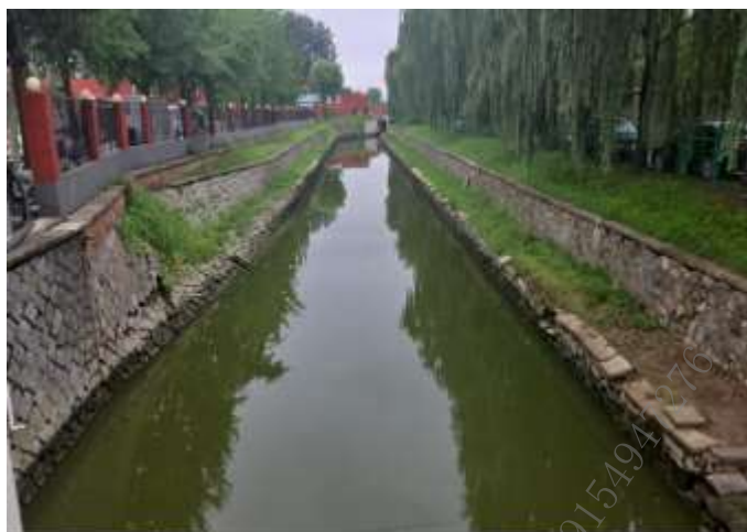
图 9 大稿沟小镇百汇护坡坍塌
