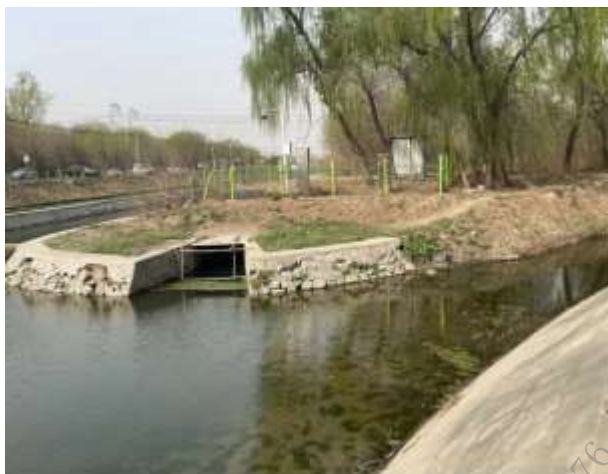
图 1 南大沟与南大沟支沟交汇处护坡坍塌
