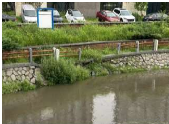
图 6 大柳树黄厂西路柠檬公寓处护坡坍塌
