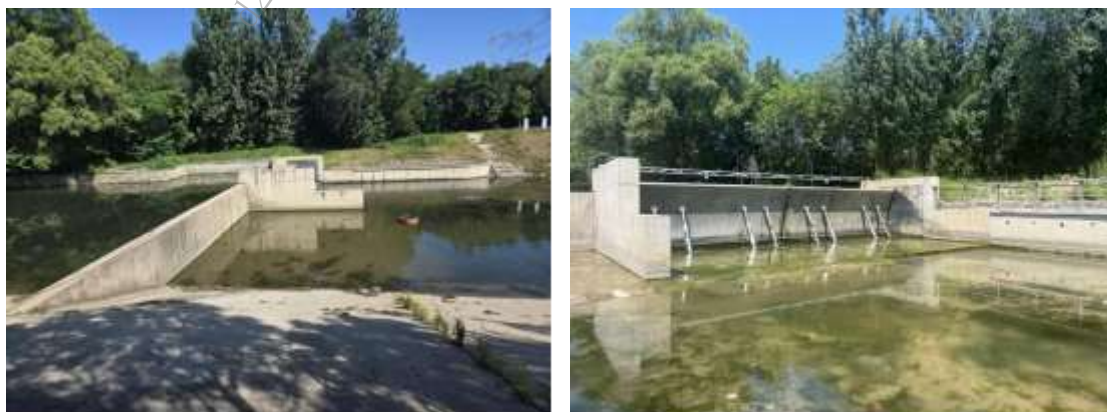
图 8 萧太后河通马路翻板闸
