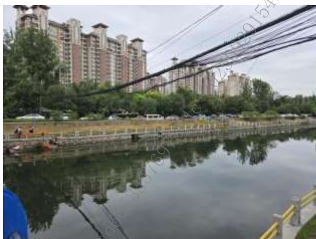
图 4 大柳树沟天达路桥上游河道护坡坍塌
