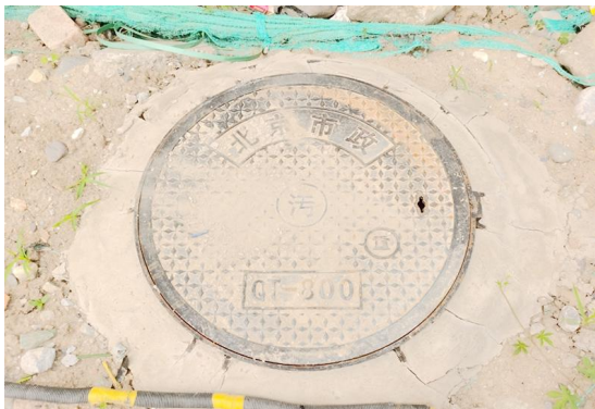
项目内下水检修井
