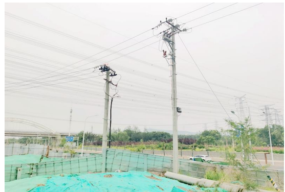
项目内高压线杆
