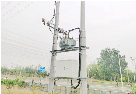
项目内变压器
