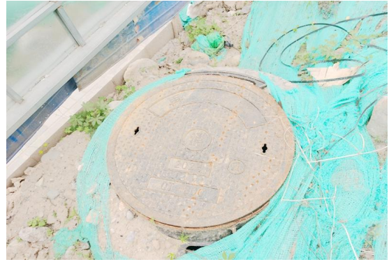
项目内上水检修井
