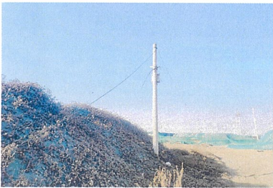
项目内通信线杆
