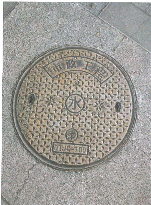
项目内上水检修井
