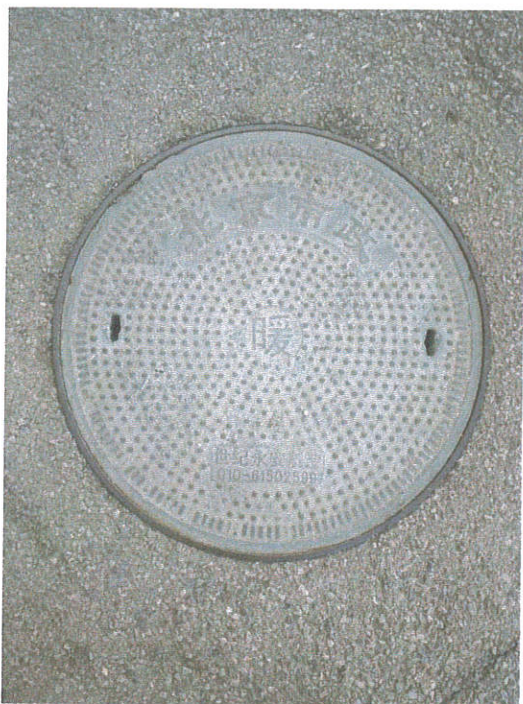
项目内热力检修井
