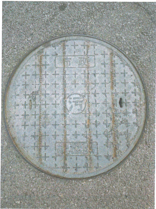
项目内污水检修井
