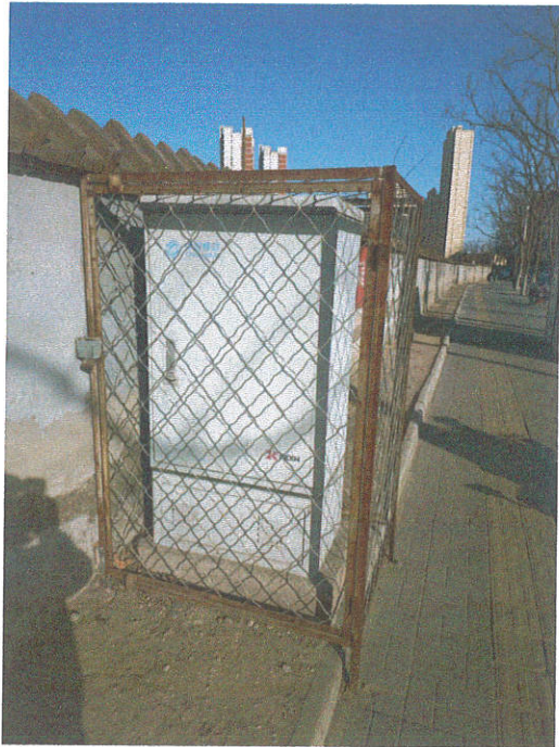
项目内变电箱
