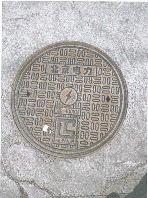
项目内电力检修井
