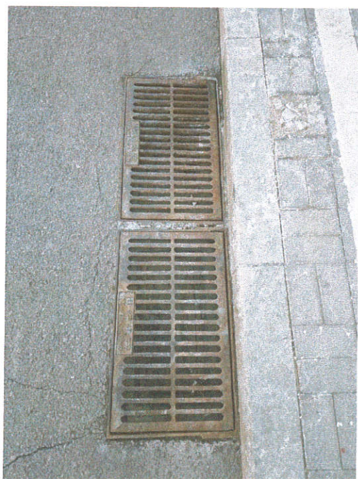
项目内雨水篦子
