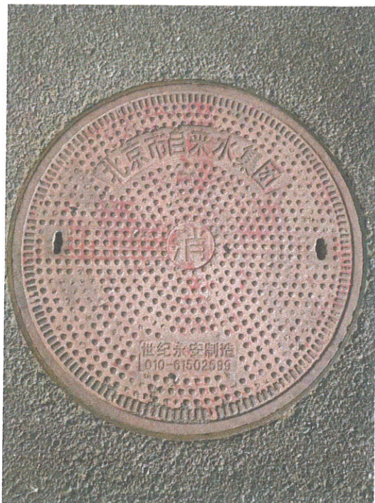
项目内消防井
