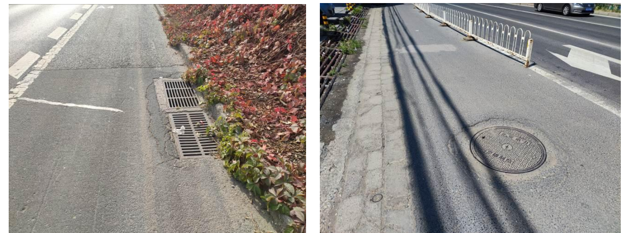
图 3.5-2 雨水口破损沉陷
