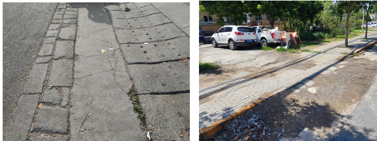
图 3.4-2 穿村段附属设施部分破损
