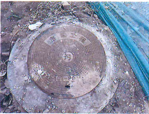
项目内的检修井
