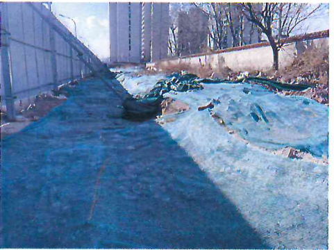
项目内未加固的陡坎
