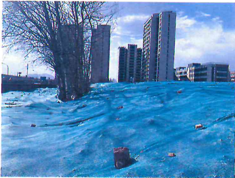
项目内未加固的斜坡
