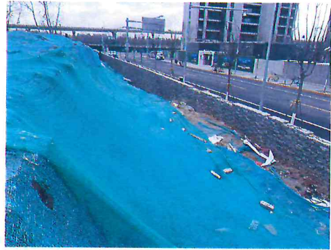
项目内未加固的陡坎
